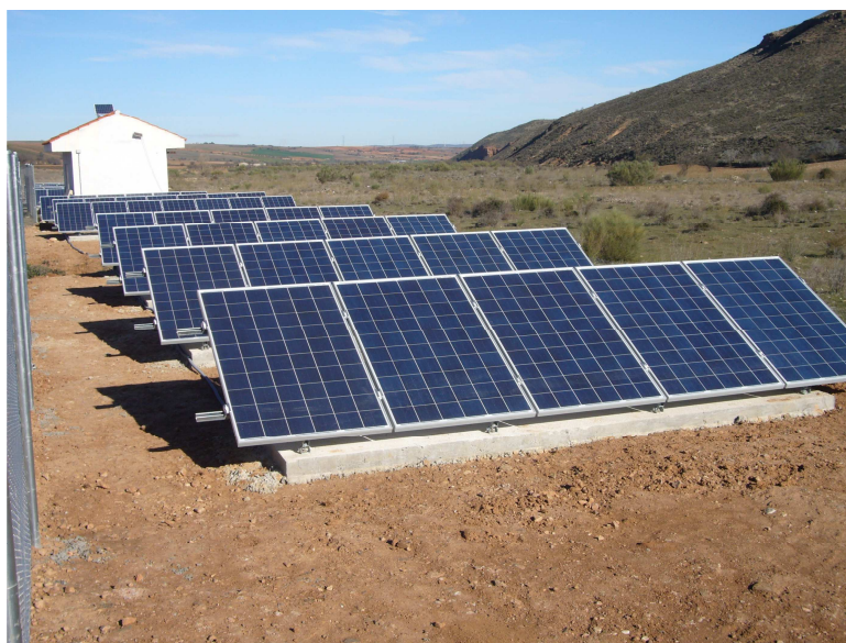
Instalación solar fotovoltaica para abastecimiento de agua de 14,2 kW (Villar de los Navarros, Zaragoza)
