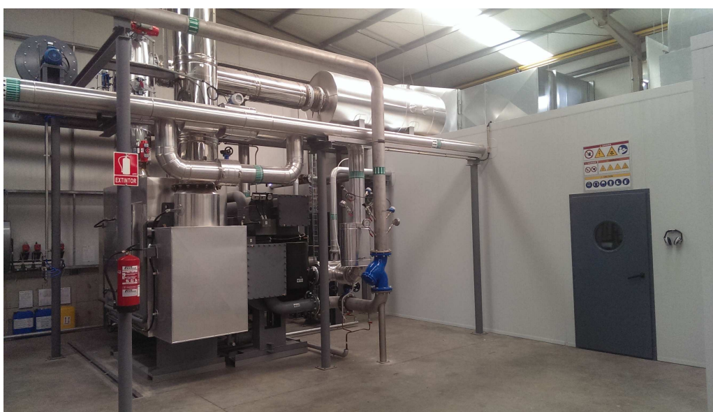
Central de trigeneración de 1 MW (Mallén, Zaragoza)
