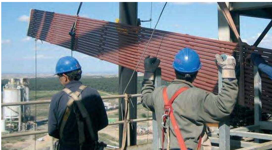
Mantenimiento en Central Térmica (Andorra, Teruel)
