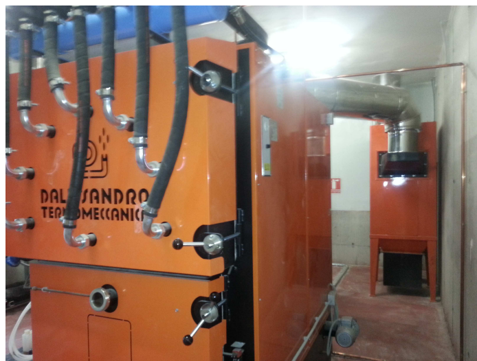
Caldera de biomasa de 400 kW (Belchite, Zaragoza)
